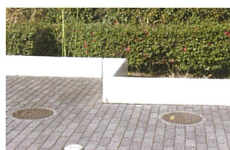
←災害トイレ用マンホール
