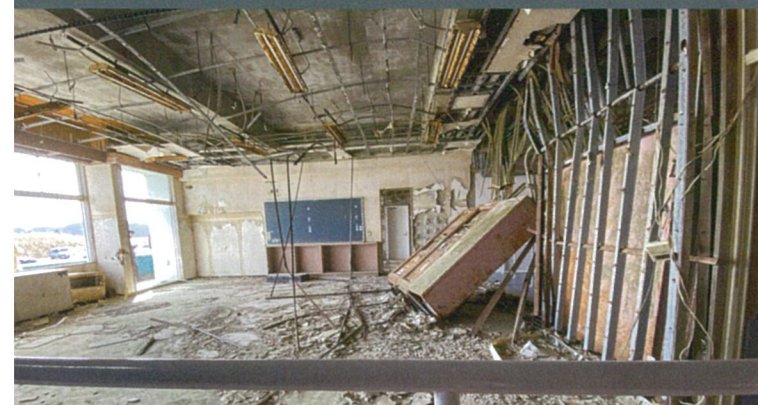
天井の鉄筋も崩れ落ちている職員室。校内の一部は通路が整備され、見学ができる。
