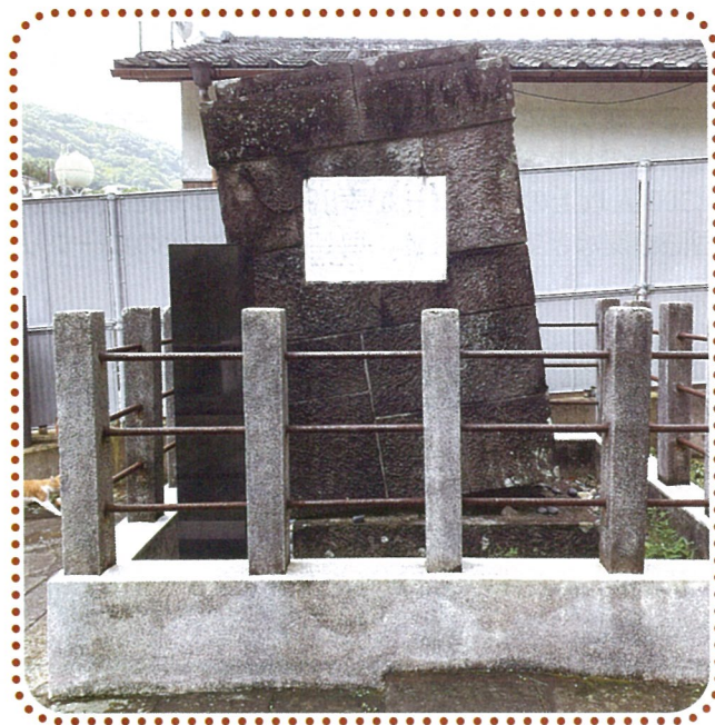
写真：旧長崎医科大学門柱。台座の上に真っすぐに立っていた門柱は、爆風で9cmも前にずれ、台座との間に最大16cmの隙間ができた。この門柱を含む長崎原爆遺構は、2016年に国の史跡に指定されている（長崎市提供）
