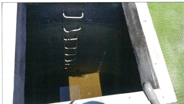
豪雨災害で取水口が破壊されて水がたまらなくなっていた貯水設備
